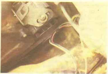
Пучок проводов, идущий к коммутатору, расположен вблизи от шкива генератора, от сильной встряски провода могут легко попасть под вращающийся шкив или ремень.
